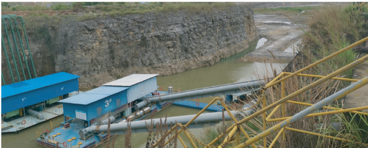
▲ 平南公司矿山区域浮船排水泵
